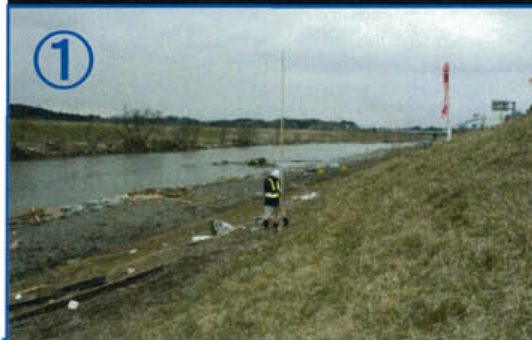
① 漂流物の状況。 (R6.0k付近)
