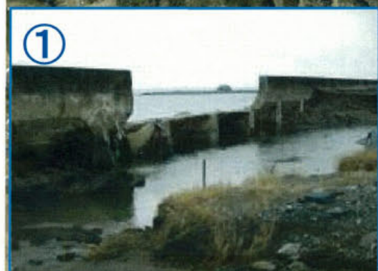
特殊堤が一部流出。 (R0.3k付近)
