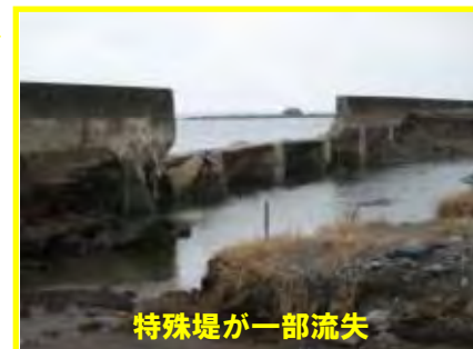
特殊堤背後が大きく侵食
