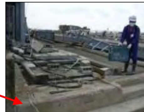
＜発電機室の流失＞
