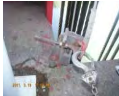
メッセンジャーワイヤー転向シーブ折損
