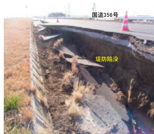
近傍の被災状況写真 (27k 付近)
