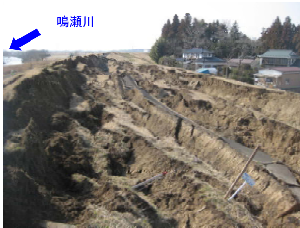
写真① 表のり面は幾重にも縦断亀裂が発生するとともにはらみ出しが見られる
