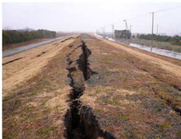
被災箇所の状況
