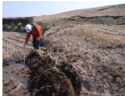
写真④ 裏のり尻のはらみ出し状況 末端部ではらみ出しが見られる
