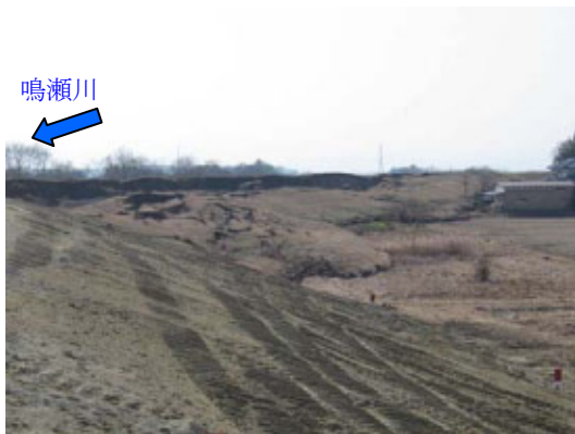
写真③ 裏のり面のはらみ出しが見られる
