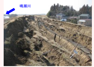
堤体の液状化による堤防被災
