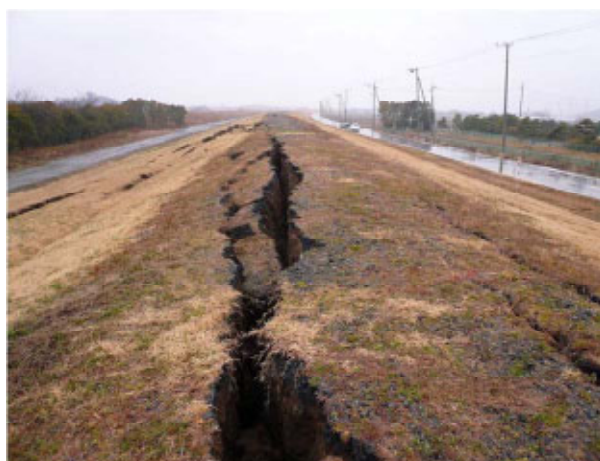
被災箇所の状況
