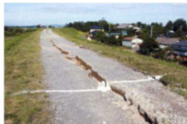
H15地震後の被災状況(天端縦断亀)
