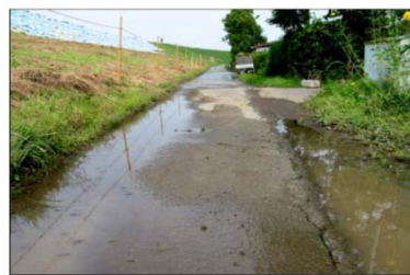
H15地震後の被災状況(川裏尻からの染出)
