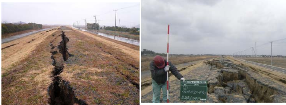
○東北太平洋沖地震による被害状況
