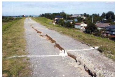
H15地震後の被災状況(天端縦断亀)
