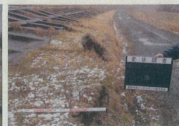
写真④堤外側法尻はらみ出し、ブロック破損
