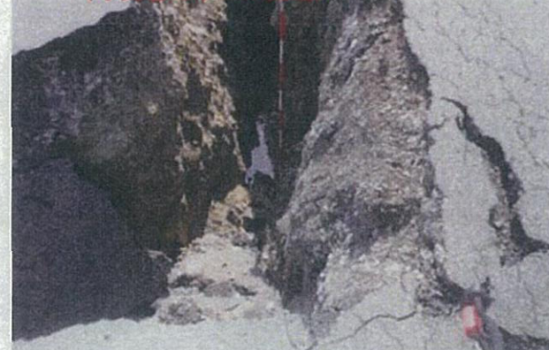
写真②天端クラック底には水が確認される (写真①のポール参照)
