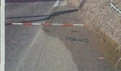
写真⑥裏のり尻の噴砂跡。のり尻は国道側にはらんでいる。
