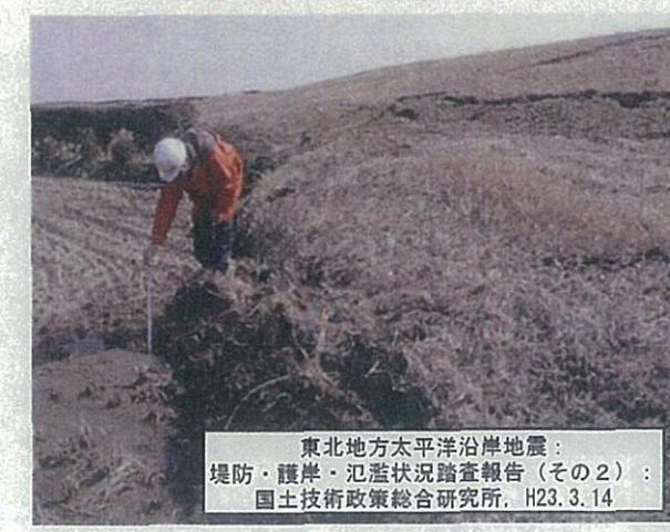
写真④ 裏法尻のはらみだし状況 末端部ではほらみだしが見られる
