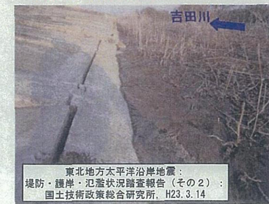
写真④護岸端部の噴砂
