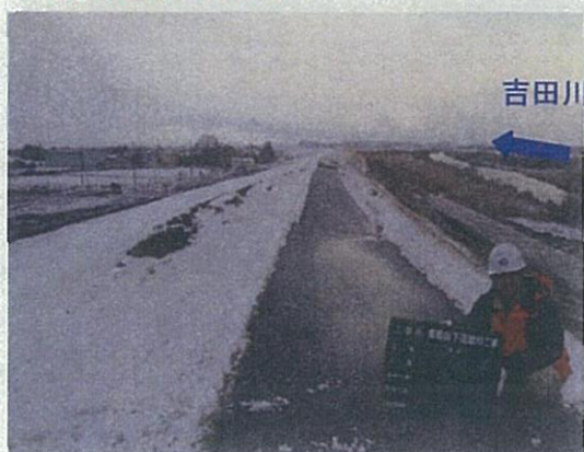
写真①天端全体が沈下
