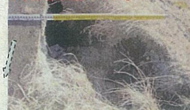
写真①裏のり天端の縦断クラック。深さは最大で4m。
