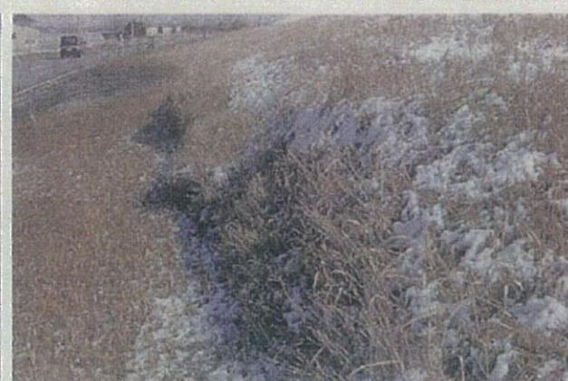
写真②堤内側法尻付近のはらみ出しと湿潤状態
