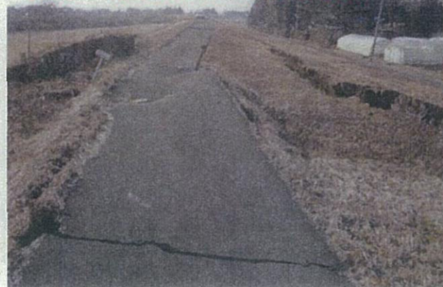
写真③22k付近の天端の沈下とうねり状況
