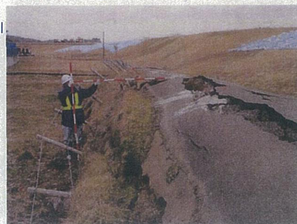
写真③裏法の測道は隆起、はらみだしが見られる
