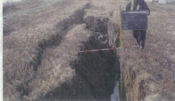
写真①22k付近の裏法縦断クラック。幅は2m、深さは約1.1mに達している。クラックの底に水が確認される。
