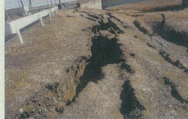
写真③表法には幾重にも縦断クラックが発生すると共に孕み出しが見られる
