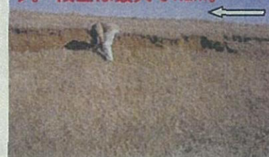
写真③裏のり上部の縦断クラック。段差は最大で1.2m。
