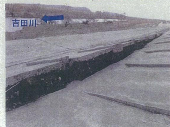
写真②護岸の沈下、段差が発生
