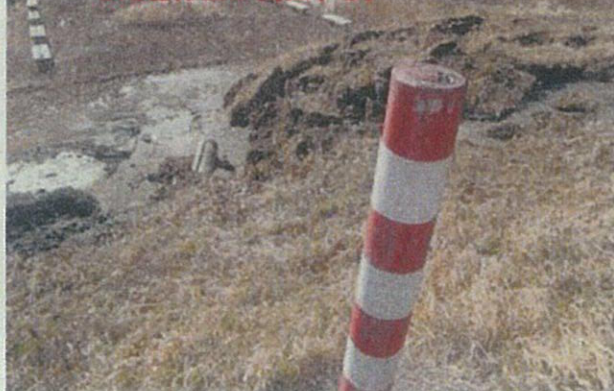
写真②法尻付近には液状化した土砂と泥土化した塊体土が流出する。
