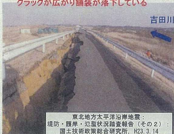
写真①天端が沈下し、川表に傾斜している天端川裏側は クラックが広がり舗装が落下している
