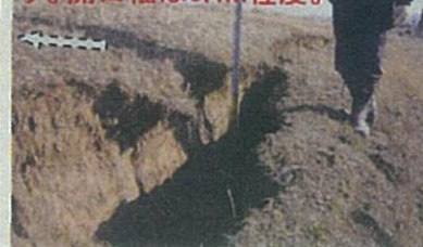
写真②裏のり上部の縦断クラック。開口幅は0.4m程度。
