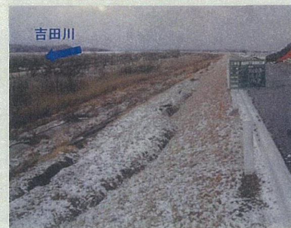
写真②表法には幾重にも縦断クラックが発生 すると共にはらみ出しが見られる
