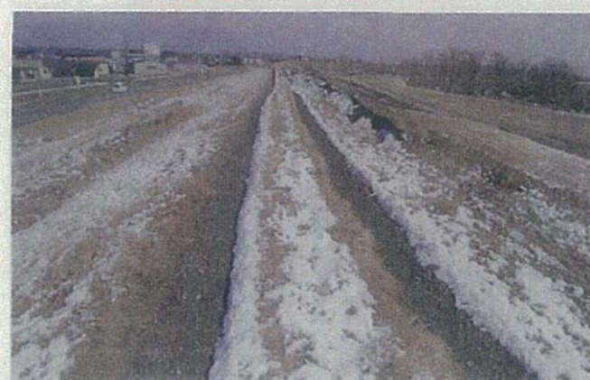
写真①堤防全体的に沈下・陥没
