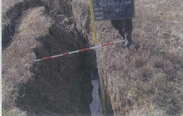
写真②22k付近の裏法縦断クラック底で確認される水
