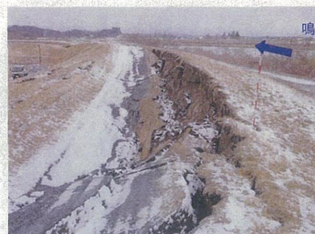
写真②天端が沈下し、裏法には幾重にも縦断クラックが発生すると共にはらみだしが見られる
