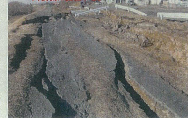
写真④天端には幾重にも縦断クラックが発生し、川表側に変位する。
