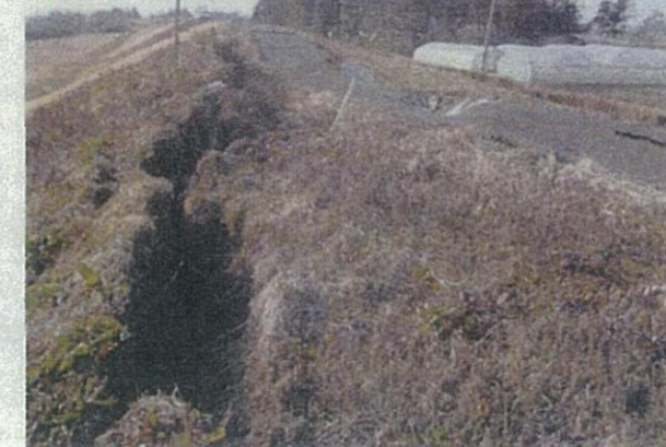
写真④22k付近の天端表法兩側面の縦断クラック
