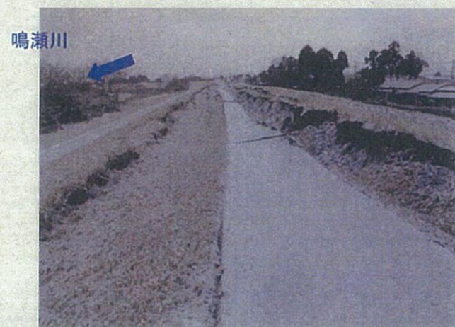
写真①: 天端全体が沈下
