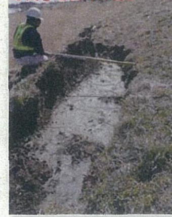
写真③亀裂内の噴砂
