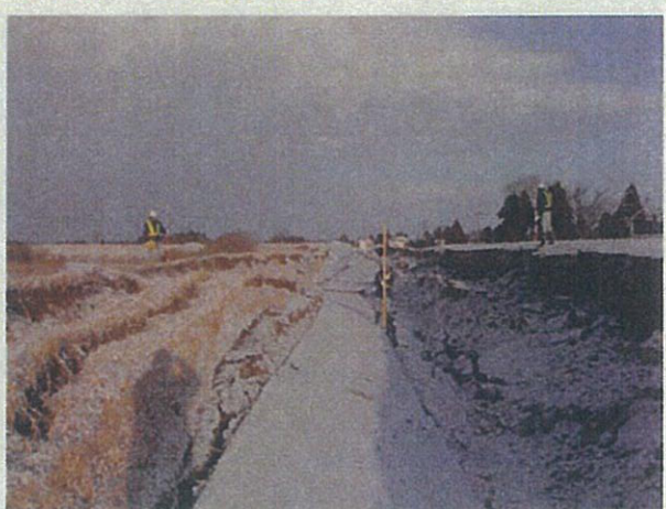
写真②: 天端の沈下量 3.0m
