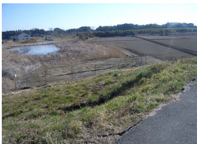
↑ 川裏法面クラック状況(約1m)
