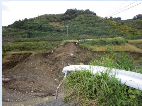
④道路兼用堰堤の崩壊
