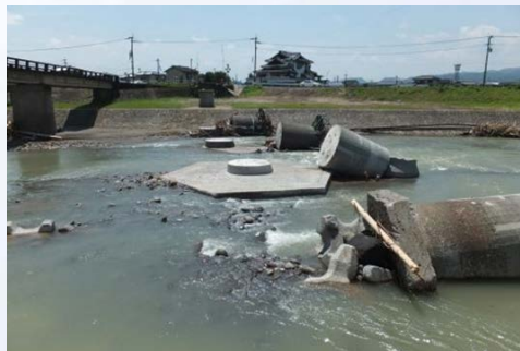
②JR久大線鉄道橋 被災状況
