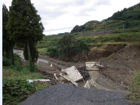
②上流溜池の堰堤崩壊
