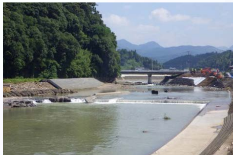
①筑後川合流点付近被災状況
