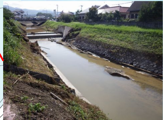
河床が低下し、石積護岸の基礎部分が水面上に露出。
