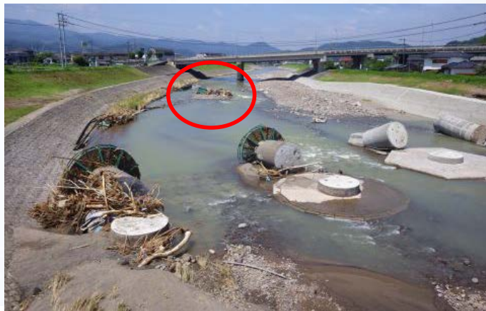
上流側からの全景。倒れた橋脚の先に橋桁を確認。
