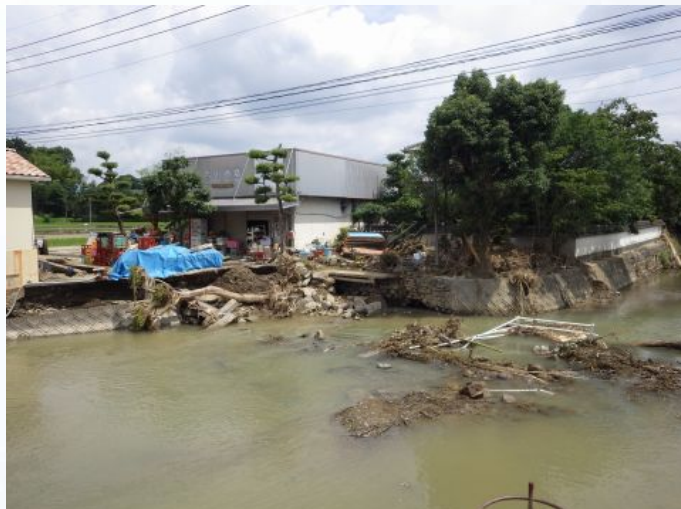
石橋が崩落。右岸が侵食。
