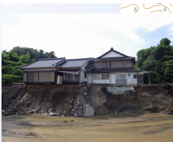
基礎部分まで侵食された住家。
