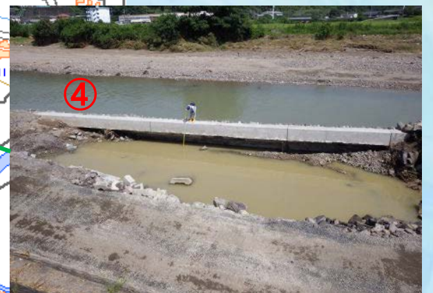
左岸0k付近の低水護岸裏の侵食箇所。
