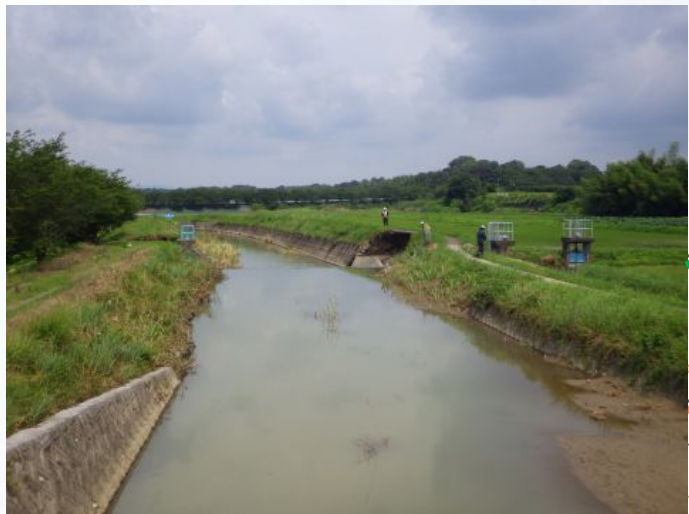
上流側からみた堰と侵食箇所。
