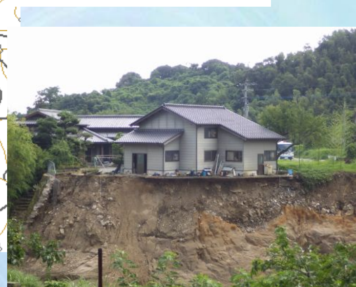
同様に基礎部分まで侵食された住家が多数存在。
