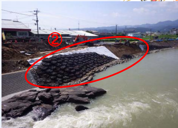
左岸0.5kの河岸侵食箇所。
