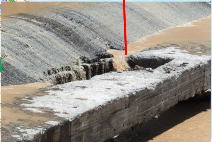
堰の基礎部分が洗掘されている。また、水たたき中央部に穴が空いている。(今次災害による穴であるかは不明)
