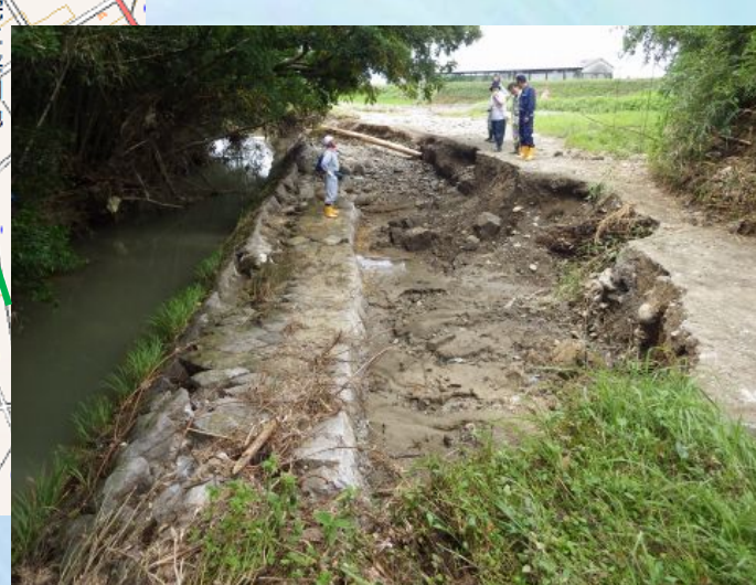
上流からみた護岸背面の侵食状況。
