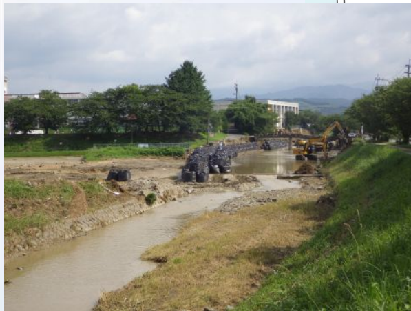
下流右岸の堤防が決壊し、氾濫が発生。
