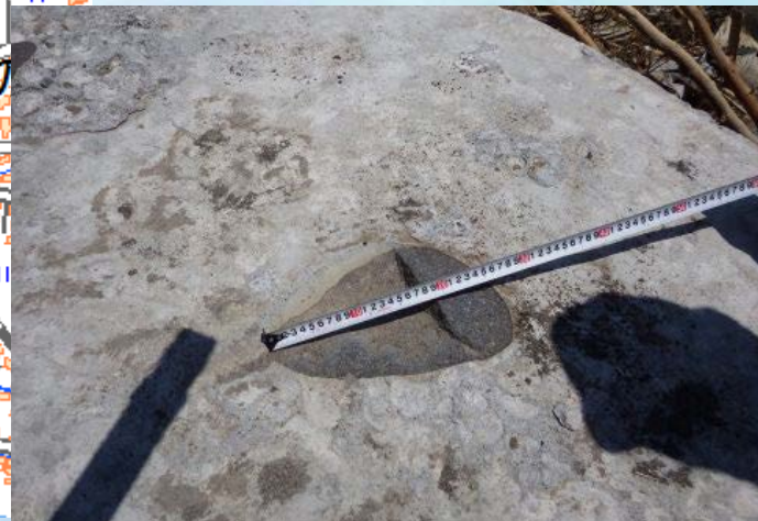
橋脚は無筋であり、打継部に4つの玉石が埋め込まれている。玉石は人頭大25cm程度、橋脚折損時に破断。
