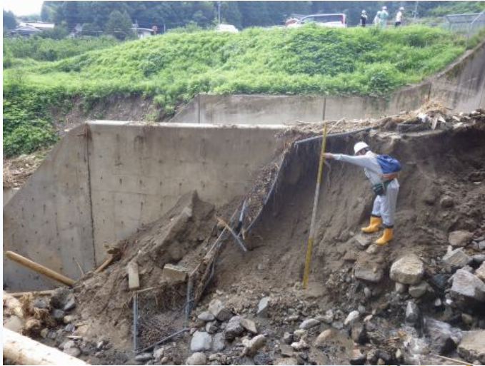
護岸裏側の侵食状況。
