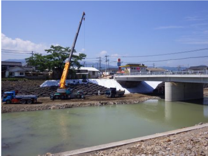
光岡橋の上流、右岸から左岸の侵食箇所を望む。
