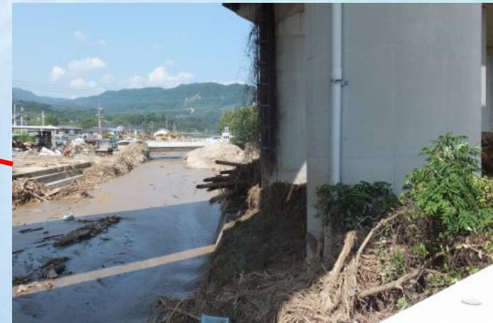
迂回流の法線上に流木が堆積。
