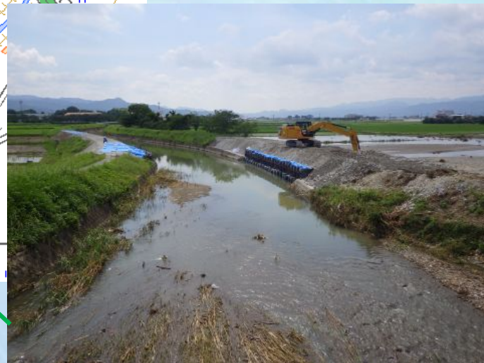
下流の左岸堤防決壊、右岸堤防欠損。
