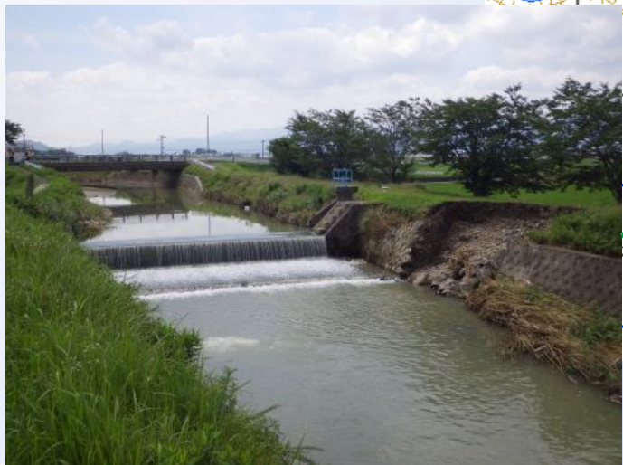
堰と左岸側の侵食箇所。
