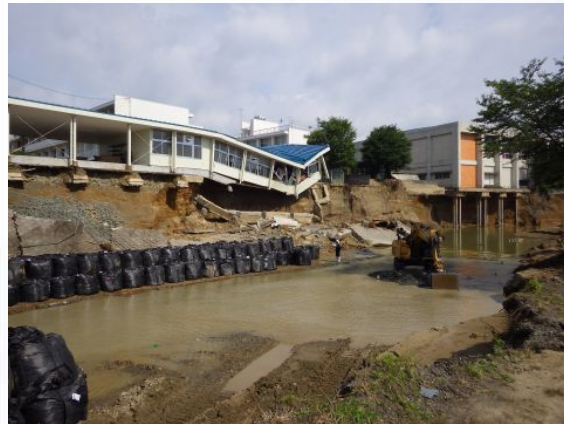
右岸が侵食され学校の建物の一部が倒壊。
