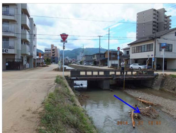
ee. 桁下約 1mの高さまで砂礫が堆積していた。明らかに河積が減少している。(弘法川)
