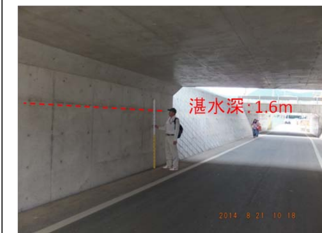
k. 県道 8 号線と国道 9 号線が交差する地点のアンダーパスで確認した浸水痕跡
