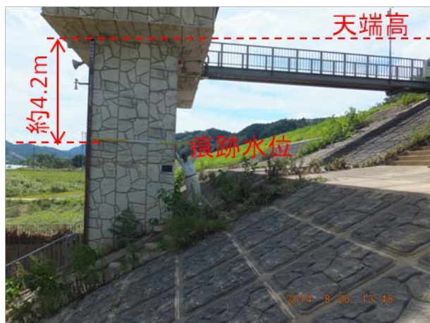
e. 蓼原川樋門に残る洪水痕跡（堤外地側）。最高水位は堤内地側よりも低い。
