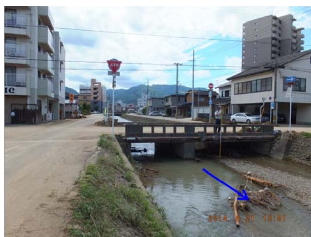
写真 - 7 福知山市民病院近傍の河道の状況
