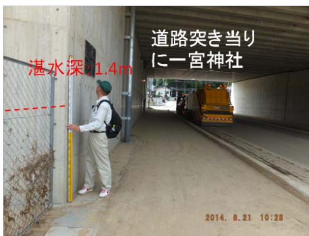
q. 一宮神社に向かって地盤高が高くなっており、一宮神社では浸水していない。
