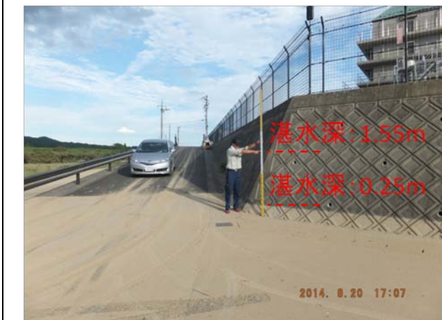
g. 下荒河浄水場の嵩上げ盛土の擁壁に付着した浸水痕跡。最大湛水深の他に、泥の付着が明確な低い痕跡を確認できる。冠水した水が引いていく際に、低い水位が一定時間維持された結果と推測される。
