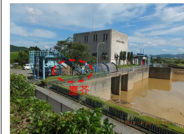
1) 荒河排水機場の外観。沈砂池には濁水が残る。水位痕跡は沈砂池周辺の垣根を水没させる程度の位置に確認された。スクリーンで回収された塵芥が残っている。
