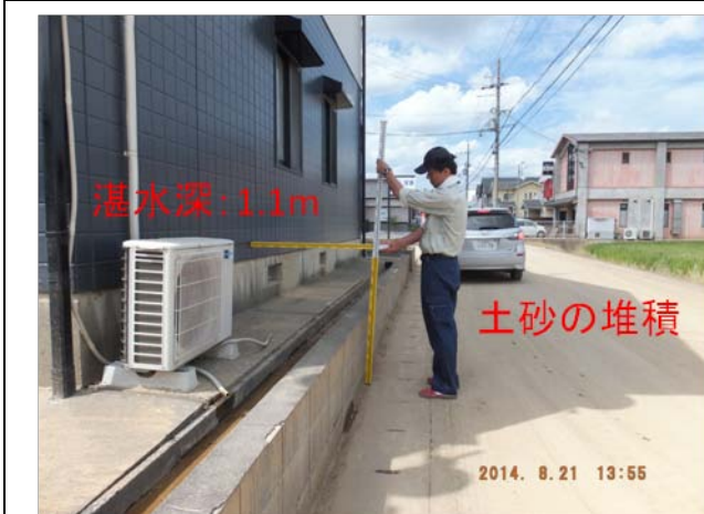
qq. 西川から1ブロック程度離れた宅地で確認した浸水痕跡。地盤高が沿川に比べ 50cm 程度低くなっていた。
