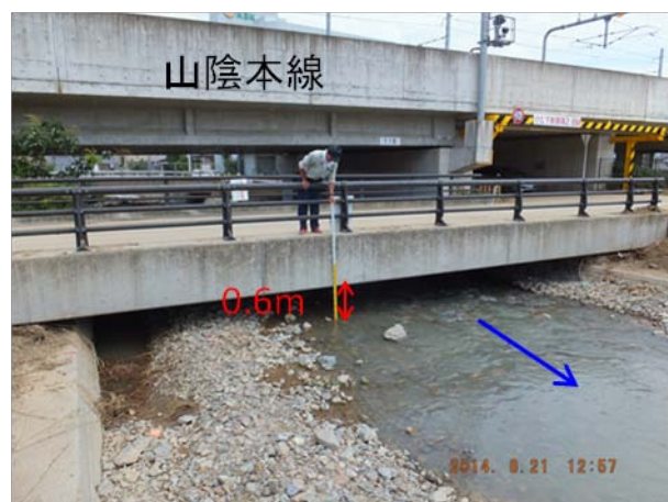
写真 - 6 河道閉塞に近い状態の橋梁
