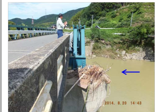
c. 天津橋の橋桁底面付近に残る洪水痕跡
