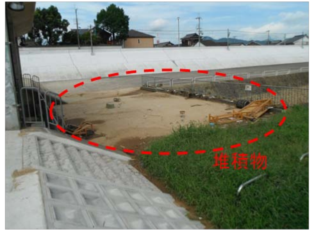
4) 函渠の川側の天端には厚く土砂が堆積していた。直角に近い角度で湾曲する由良川の外岸側で死水域が生じ、土砂を堆積させたと考えられた。洪水痕跡は高水敷上 1m程度（目測）であった。
