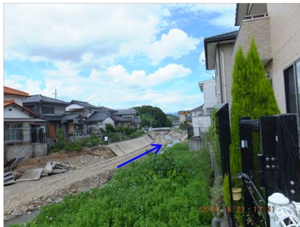
ll. 弘法川上流部で生じた護岸の崩壊。民家の外堀の基礎が崩落していた。残された護岸の表面は健全であることから、河床低下による護岸の崩壊と推測された。
