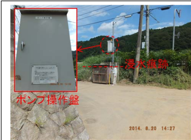
e. 大呂川脇にあるマンホールポンプ操作盤も河川水位に合わせて嵩上げされていた。
