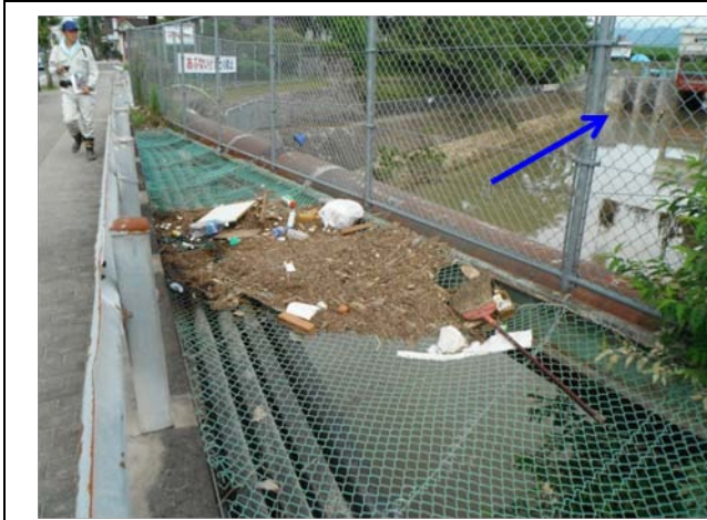
3) 沈砂池へと法川が流入する地点では橋桁脇に設置された落水防止ネット上に塵芥が堆積していた。
