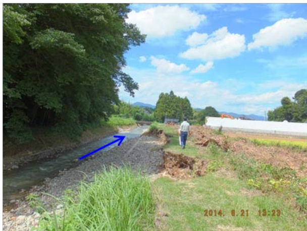
kk. 弘法川上流で確認した河岸侵食。山地部崩壊や河岸侵食によって発生した土砂が下流へ運搬され、弘法川での土砂の堆積を促進したものと考えられた。
