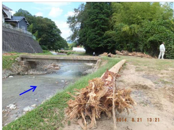
jj. 弘法川上流では流木が散乱していた。山地部で地すべりが発生していたと考えられ、出水時に橋梁下を塞いでいたものを除去したものと推測された。周辺の田圃には橋の脇から越流した水流によって侵食された痕跡が残されていた。
