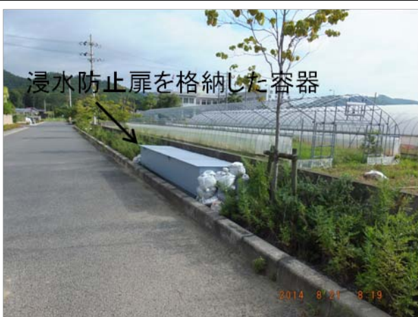
g. 浸水防止板を格納した容器が施錠された状態で開口部脇に置かれていた。土嚢も 20 袋程度準備されていた。袋の劣化状態からすると、比較的新しいものと推定された。
