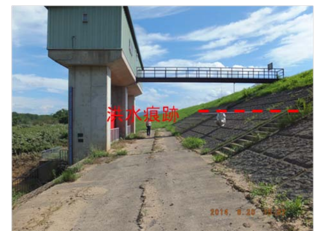
4) 由良川の樋門周辺に残る洪水痕跡
