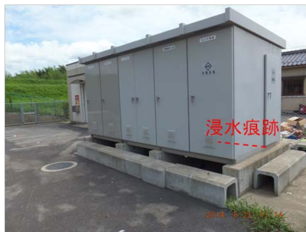
写真 - 3 蛇ノ端ポンプ場の変電設備
