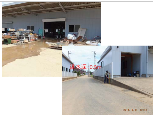
dd. 弘法川沿川の工場。フラットな床は荷物の出し入れが便利だが、浸水の影響を受けやすく床一面に土砂が堆積。左上の工場脇の道路で確認した浸水痕跡。
