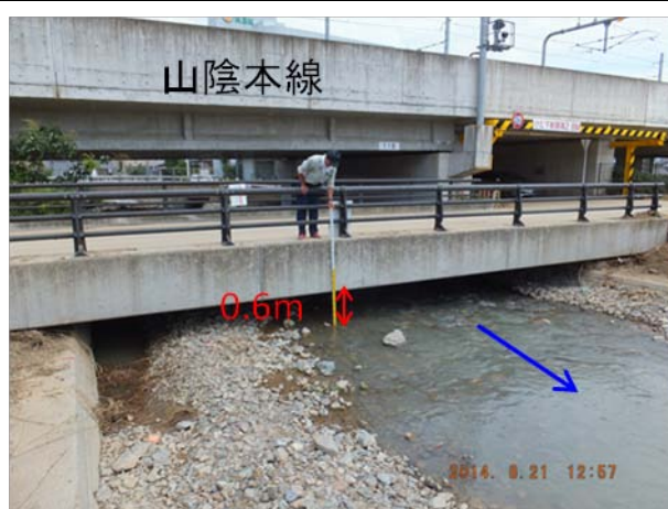
hh. 土砂で埋まる弘法川。桁下 0.6m 程度まで土砂が堆積し、洪水は橋の上流側で溢れ、下流へと拡散していったことを確認した。
