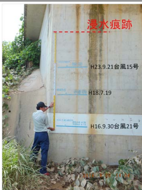
g. 国道175線アンダーパスに残された浸水痕跡の履歴。今回の大雨による浸水は平成23年9月台風15号よりも約1m高い。
