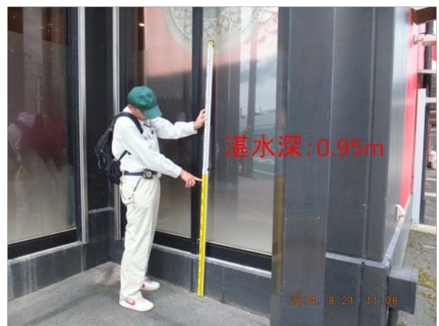
hh. 県道 55 号脇の施設に残る浸水痕跡
