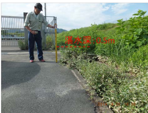
m. 弘法川救急排水ポンプ場入口脇の浸水痕跡
