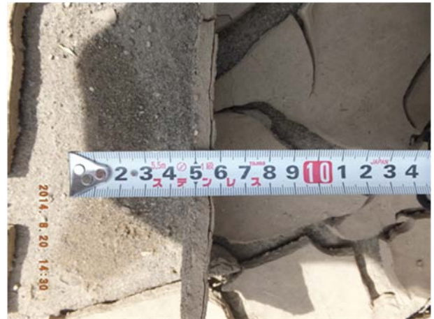
f. 大呂川に架かる橋梁上に堆積した土砂。厚さは7mm程度であるが、下層の砂分は出水前からあったものと想定された。
