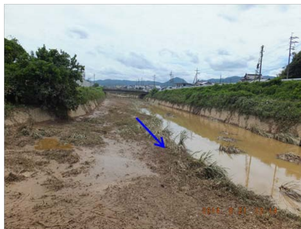
p. 和久川との交差点から弘法川の上流を望む。細粒土砂の堆積と植物の倒伏を確認できる。
