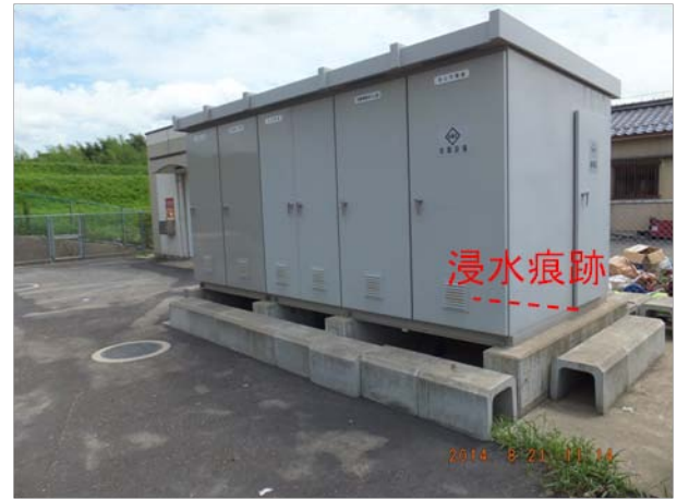
ll. 蛇ノ端ポンプ所変電設備に残る浸水痕跡。これまでに一度嵩上げされたようで、今回は 0.3m 程度冠水であり、停止しなかったようである（不具合の報告なし）。
