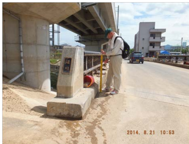
z. 山陰本線高架下の橋梁欄干で確認した浸水痕跡。地盤から 0.8m 程度。
