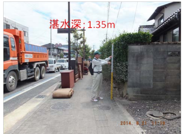
nn. 福知山河川国道事務所前交差点での浸水痕跡
