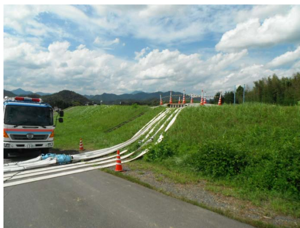
4) 川側へと延びる排水ホース
