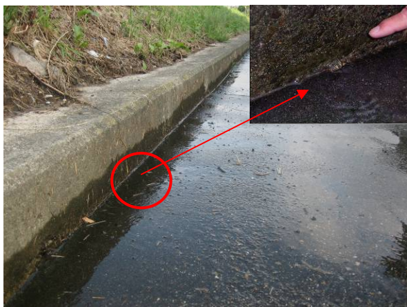
L6.0 付近 堤防背面法先部からの漏水状況
