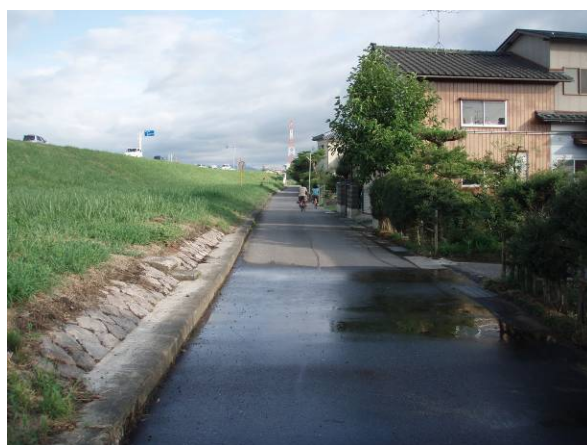
L6.0k 付近 堤防背面からの漏水状況
