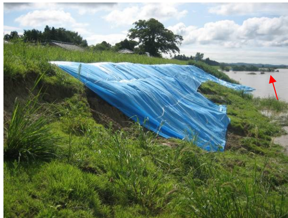
L29.2k 付近堤防川表法崩れ
