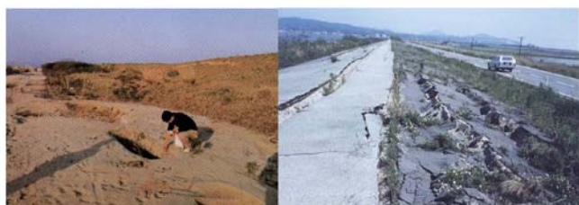
八郎潟干拓堤防（1983年日本海中部地震）
