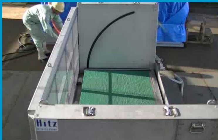
＜水位上昇に対する動作確認＞
