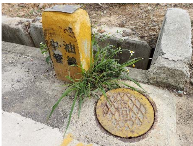
参考写真 3.2 埋設箇所
