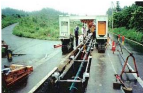
(5) パイプ吊下シクレーン
