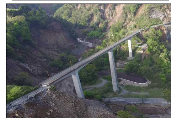
写真-8 橋台の損傷 (阿蘇長陽大橋)
