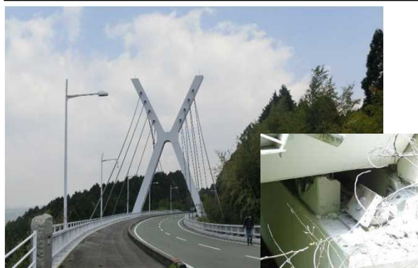
写真-6 支承部の損傷 (桑鶴大橋)
