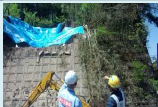
■被災状況を現地で調査
