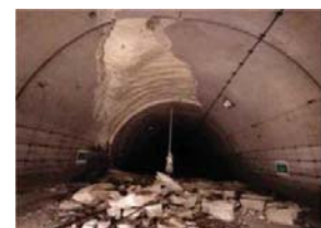
写真-13 覆工コンクリートの崩落 (俵山トンネル)
