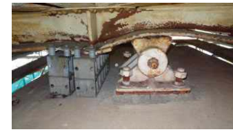
写真-1 支承部の損傷 (九州自動車道・木山川橋)
