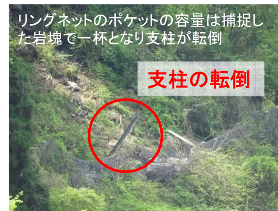
写真-2 支柱の転倒状況
