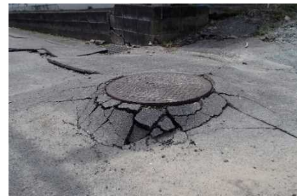
ましきまちでらさこ (国道443号益城町寺迫) 写真-5 マンホールの浮き上がり及び周辺 地盤の沈下の状況
