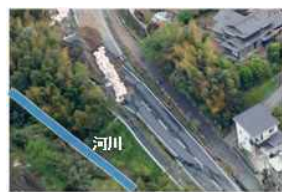
写真-8 国道443号における盛土崩壊の状況
