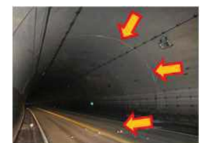
写真-14 覆工コンクリートのひび割れ (南阿蘇トンネル)
