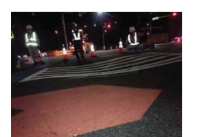
写真-12 共同溝上の路面沈下 (国道57号東バイパス田井島交差点)
