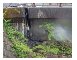
写真-5 斜面崩壊による桁端部の損傷 (村道柘の木～立野線・阿蘇長陽大橋)
