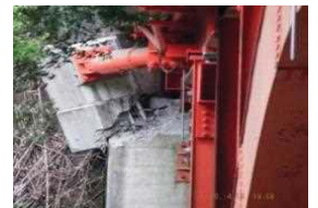
写真-7 ダンパー取付部の損傷 (国道325号・南阿蘇橋)
