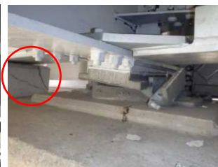
写真-6 支承の破損の状況
