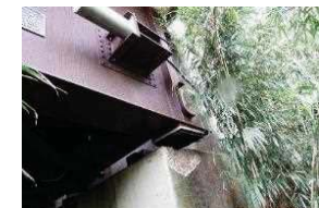
写真-6 ゴム支承の破断 (県道熊本高森線・大切畑大橋)
