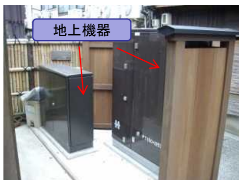
民地を活用した地上機器の設置
