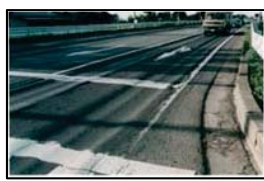
(舗装のわだち掘れ)
