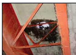
(橋梁の抜け落ち)
