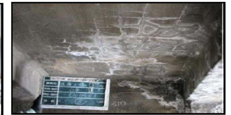
床版ひびわれ
