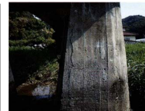
下部工の損傷状況(ひびわれ)
