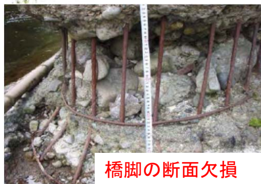
コンクリートの剥落
