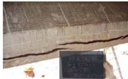
PC橋に発生したひび割れ
