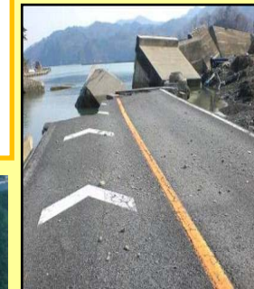
津波で被災した 国道45号
