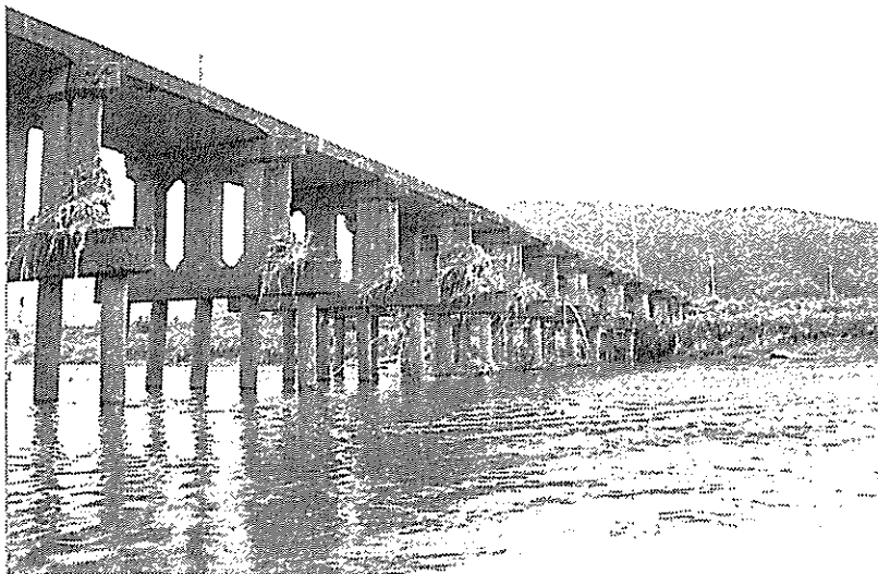
図 8.15 河床低下により危険な状態にある橋の例
