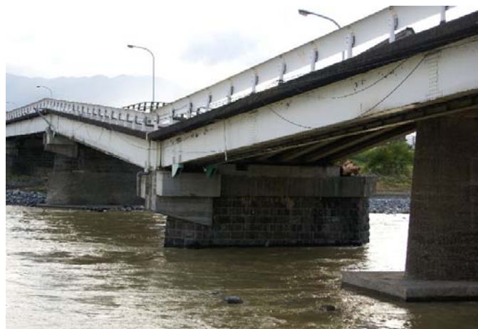
写真 1-5 橋脚周辺の局所洗掘の事例（酒匂川での事例）
