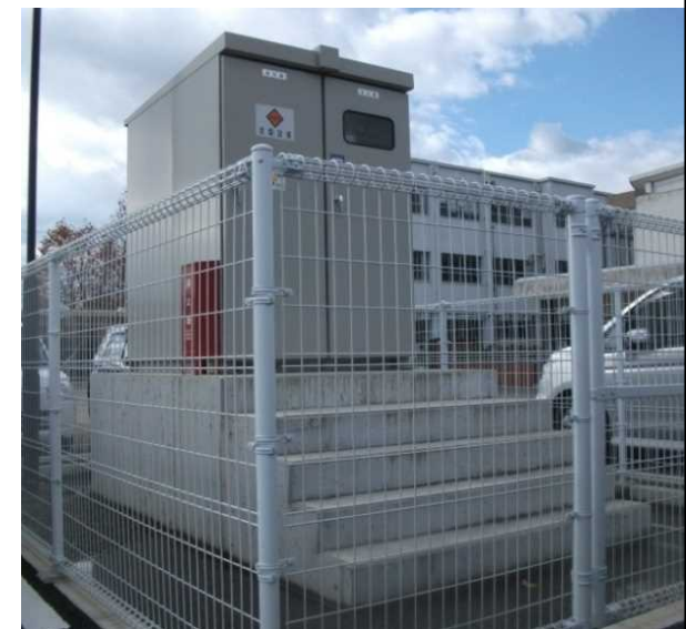
受電設備高上げ
