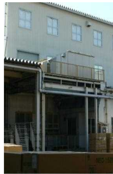
室外機高所配置
