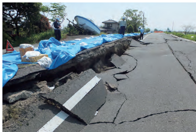
熊本地震 緑川の堤防沈下の様子
