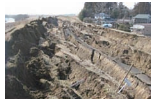
写真1 鳴瀬川下中ノ目地区
