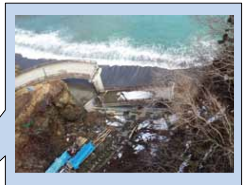
写真 2-1 津波による落橋（蛸の浜）
