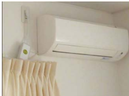
資料-12 クーラーに接続した装置
