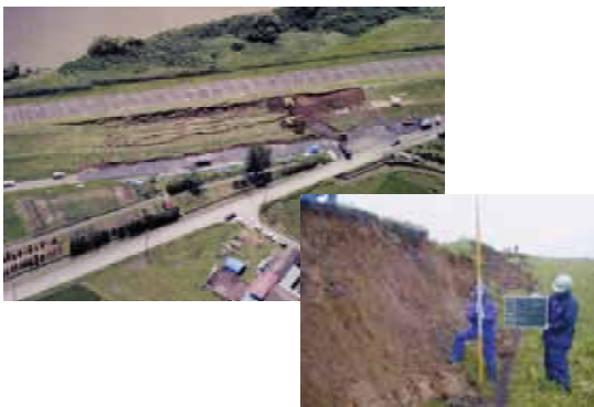
写真2 鳴瀬川木間塚堤防（2003年宮城県北部地震） 東北地整提供
