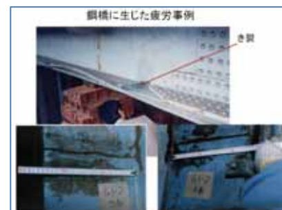
写真-2 鋼橋に生じた疲労事例
