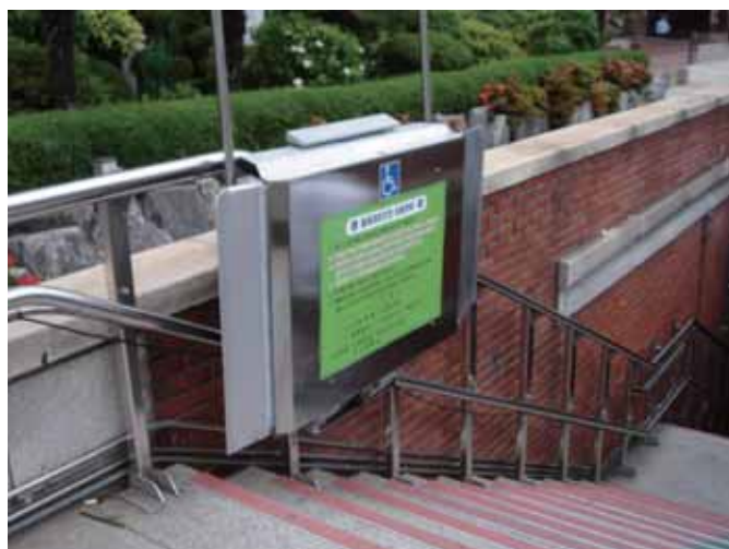
図-2 釜山の地下鉄駅の車椅子リフト
