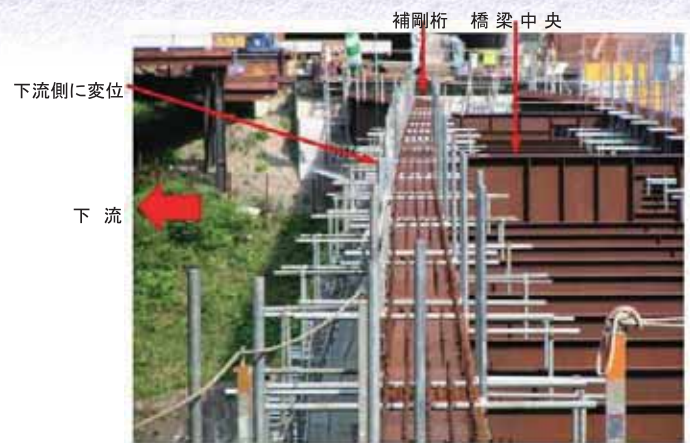
図-3 下流側にずれて架かった橋桁 3)
