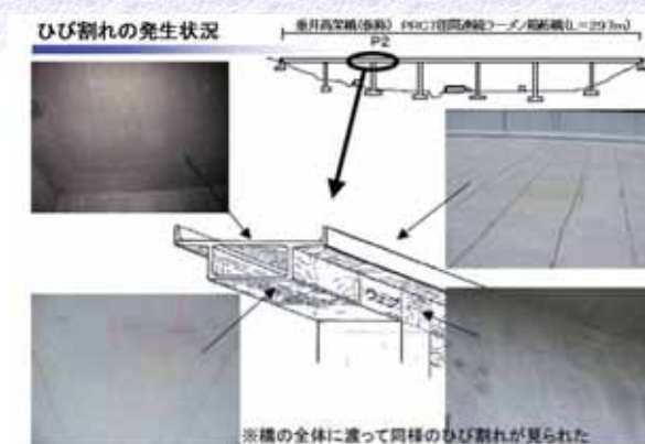
図-1 垂井高架橋のひび割れ発生状況 2)
