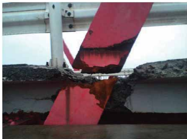
図-5 木曽川大橋・破断箇所状況 6)
