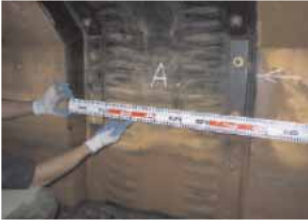
図-14 大津市街樋門の継ぎ手部の開き
