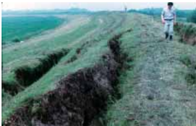
図-2 宮城県沖地震で被災した吉田川堤防
