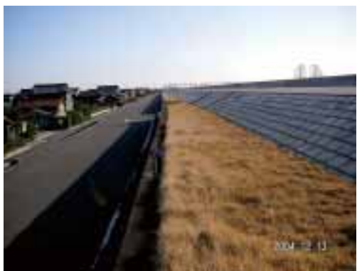
写真-3 木曾川左岸4k 堤内側状況
