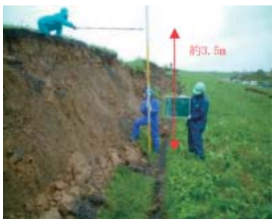
写真-2 木間塚その1 段差の状況
