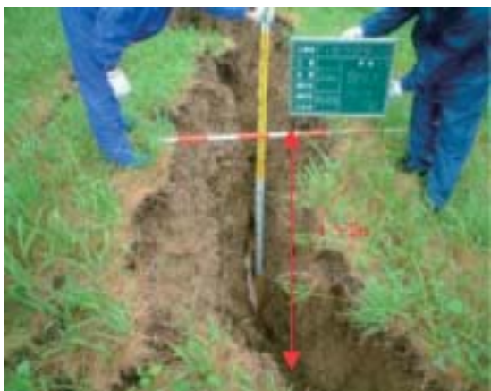
写真-3 木間塚その1 堤体川裏側の亀裂
