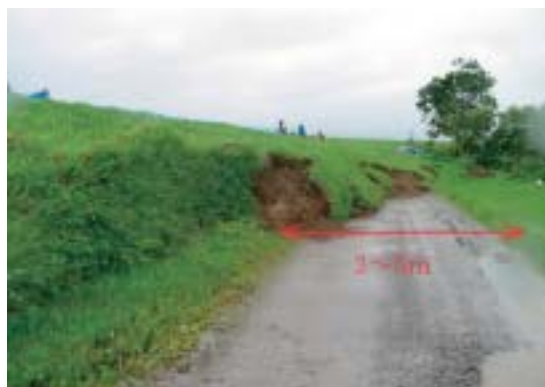
写真-4 木間塚その1 川裏側の土砂流動
