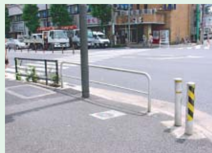
写真 - 6 隣接して設置された防護柵の色彩、形状が異なっている例
