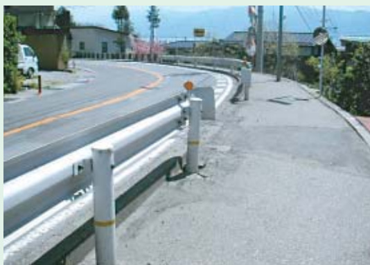
写真 - 8 ボルト類が露出する等、裏面の処理が煩雑な防護柵の例
