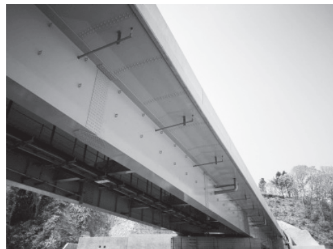
写真－6 高性能床版排水パイプ採用例
