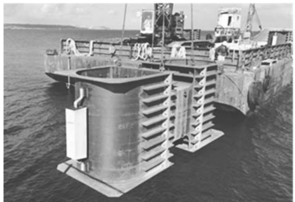
写真－2 平良港（漲水地区）岸壁（－10 m）（防波堤外）築造工事の施工状況
