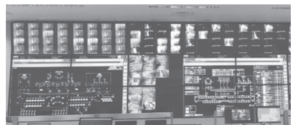
写真-2 災害時における電力制御状況
