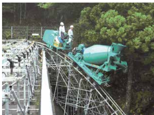
写真 - 2 ダム発電所改修工事にてミキサーを角度補正し生コンの漏洩を防止
