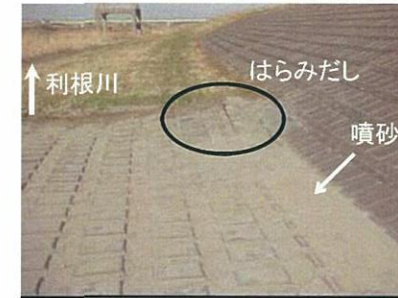
護岸のはらみだし, 噴砂(3/18)
