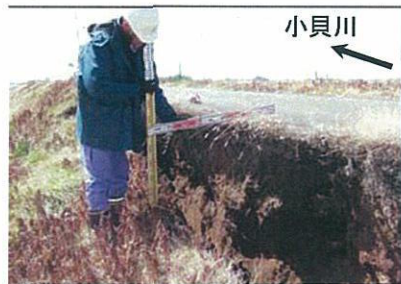
堤防天端の川裏側のり肩部の段差 (3/18)
