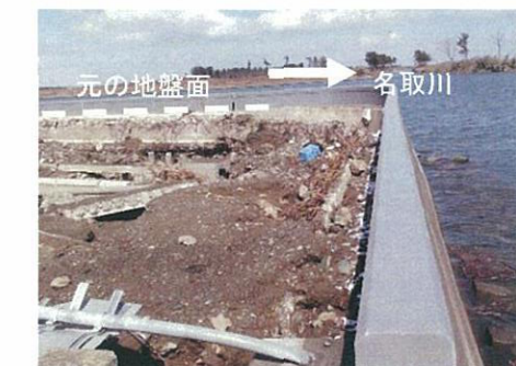
津波による堤内地盤の侵食 (関上水門の直下流, 3/18)
