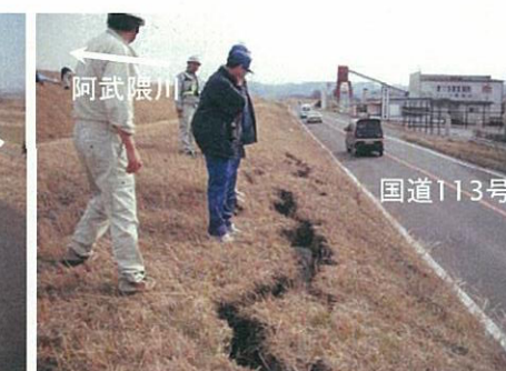
裏のりの縦断亀裂 4)
