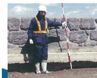
パラペット背後の沈下 (3/18)
