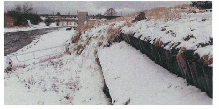
川表側のり尻部のはらみだし(3/17)
