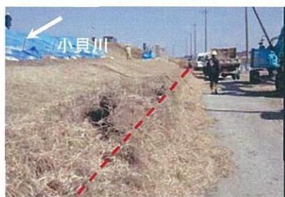
川裏側のり尻部のはらみだし (3/18)
