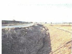
崩土が川裏側の水路を閉塞 (3/18)
