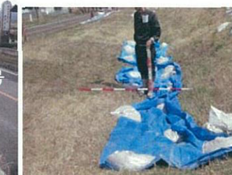
裏小段の沈下, 傾斜(4/14)
