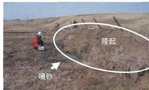
川裏側の基礎地盤の隆起と噴砂 (3/13)
