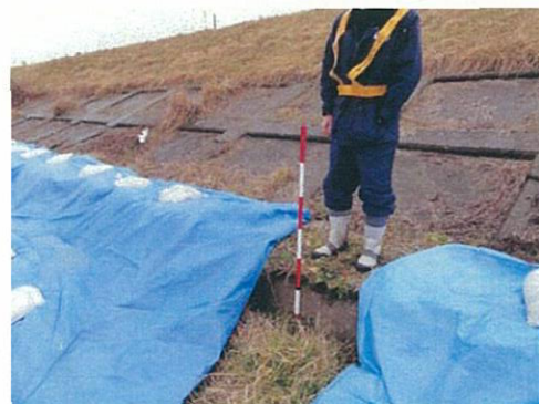
護岸ブロック下端に生じた段差・隙間 (3/16)
