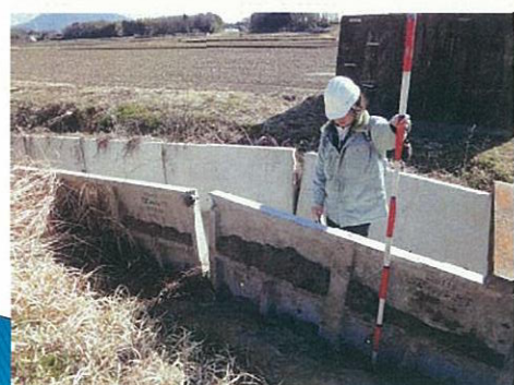
かんがい水路の浮き上がり (3/18)
