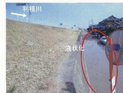
天端沈下箇所の川裏の状況
