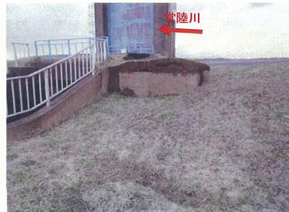
樋管の抜け上がり
