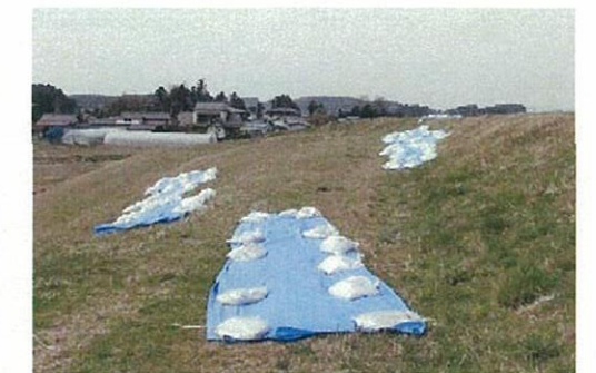
裏小段の亀裂 (4/15)
