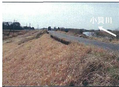
川裏側のり面の亀裂 (3/18)
