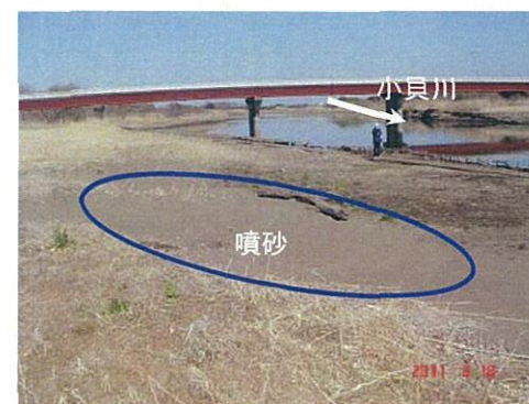
高水敷の噴砂 (3/18)
