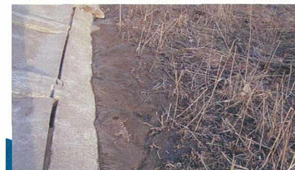
川表側のり尻部の噴砂痕(3/13)
