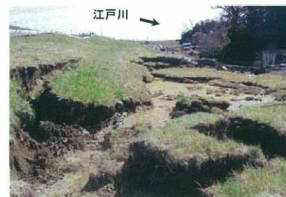
川裏側のり尻部の状況(地震発生直後)
