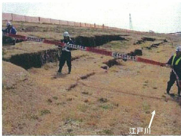
川表側のり面の状況(地震発生直後)
