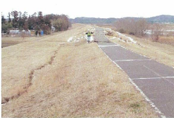
天端, 表のり, 裏のりに生じた亀裂(3/21) 3)
