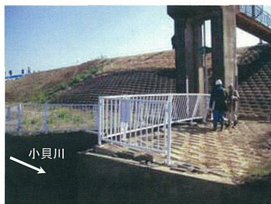
翼壁天端部の沈下 (3/18)
