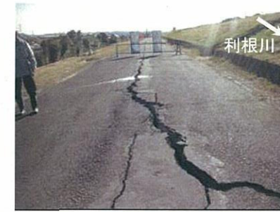
川裏小段の亀裂(3/18)
