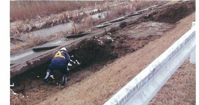
川表側護岸ブロックの前傾(3/17)
