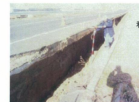
天端に生じた段差
