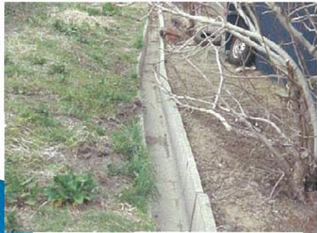
堤脚水路の変形(4/15)
