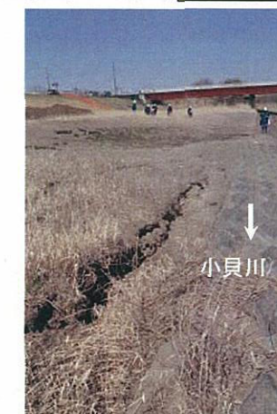
低水護岸のり肩部の亀裂 (3/18)
