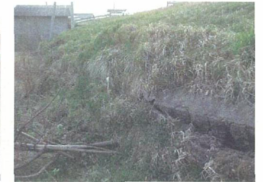
崩土に埋もれた石積み擁壁(4/15)
