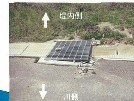
川裏側の堤脚水路の変形および噴砂 (4/15)
