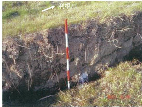
裏のり肩の縦断亀裂・沈下(3/18)
