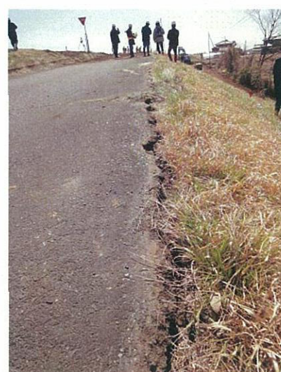
川裏側坂路のり肩部の亀裂 (3/18)
