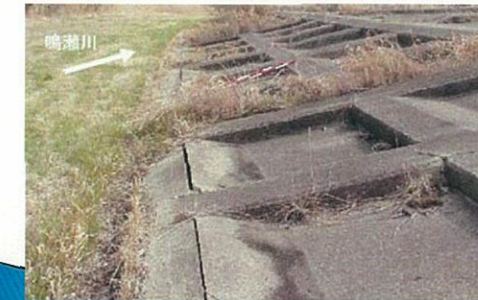
川表側のり尻の護岸のはらみ出し (無体策区間, 4/15)
