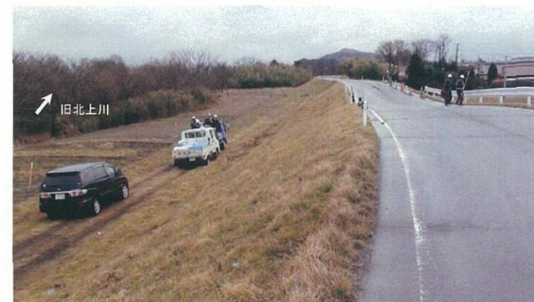
堤防天端の状況 (3/16)
