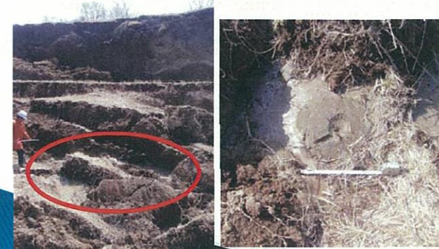
亀裂内部の噴砂痕(3/13)
