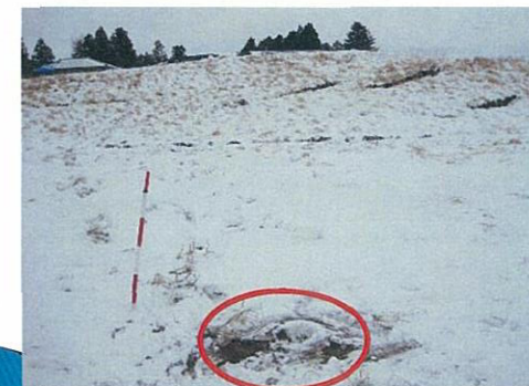
川表側のり尻部の噴砂痕(3/17)
