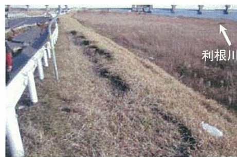
のり肩の状況
