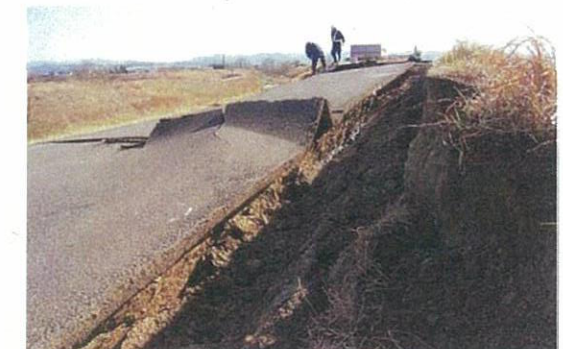
天端の沈下状況(舗装下部の拡大)*
