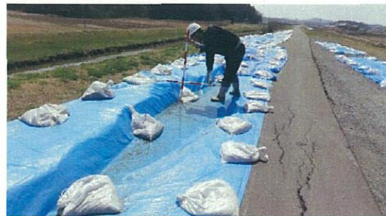
天端の縦断亀裂および段差 (4/15)
