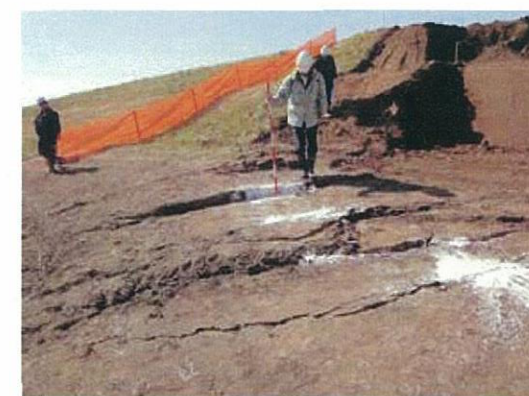
川裏側のり尻付近の亀裂 (3/18)
