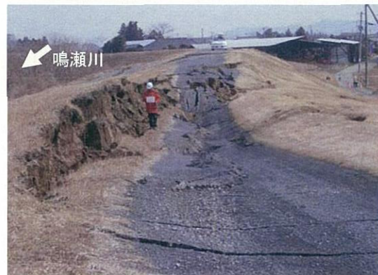
天端の沈下, 陥没 (3/13)
