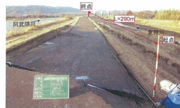
天端の沈下状況(下流側を望む)*
