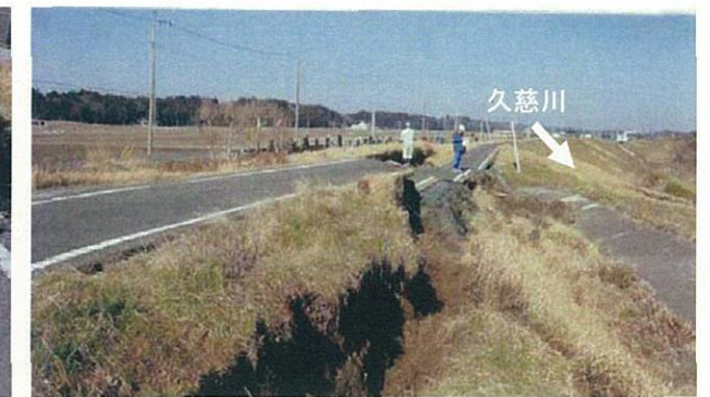
のり肩の状況
