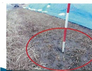
川表側のり尻部の噴砂痕 (3/17)
