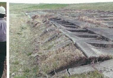
川表側の護岸のはらみ出し (4/15)
