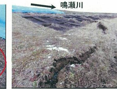
川裏側護岸ブロックの前傾 (3/17)
