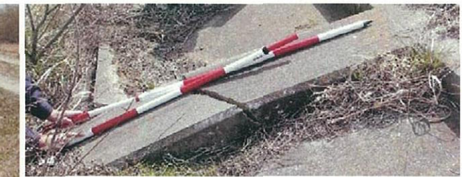
川表の護岸のり尻部のはらみ出しおよび護岸ブロックの損傷 (4/15)
