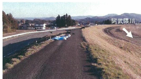
天端の状況 (32.8k付近から上流側を望む, 3/18)
