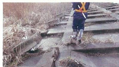
護岸下部の曲げ破壊 (3/17)
