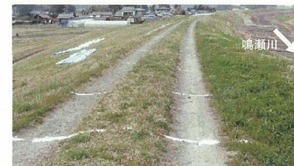
上流側端部で見られた横断クラック (4/15)
