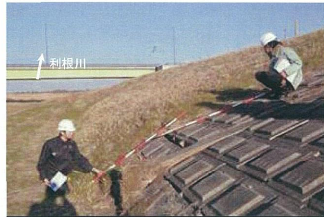
護岸のはらみだし(3/18)
