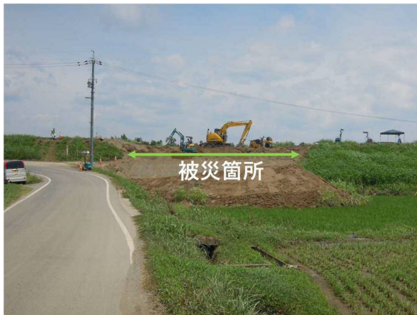
写真 4.3.1 小田川右岸 0.6k 被災状況 (7/13 調査時)
