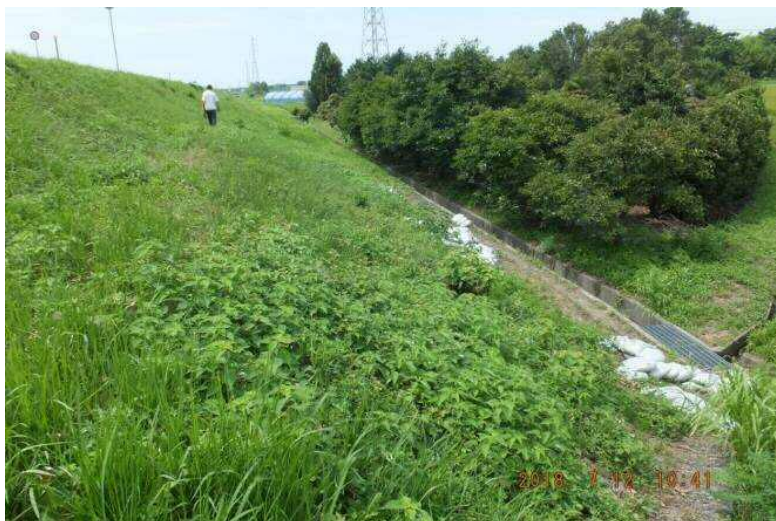
写真 4.7.1 被災堤防の裏のり
