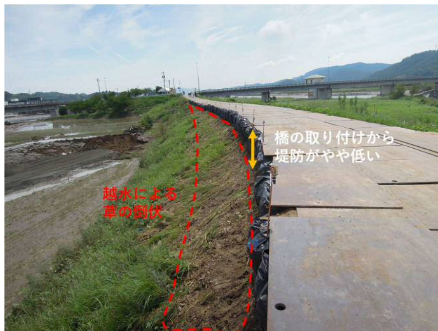
写真 4.2.3 破堤箇所下流側の堤防天端付近の状況
