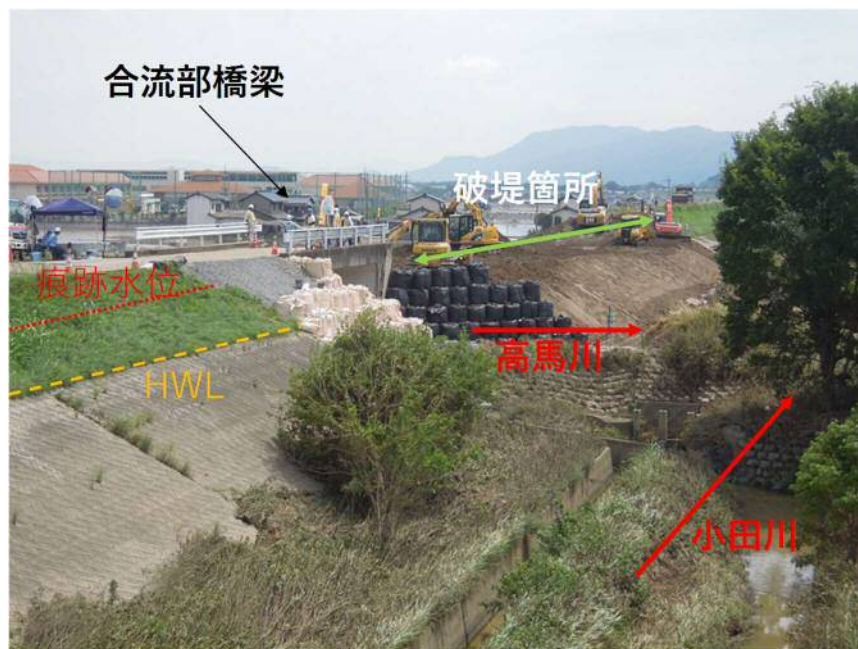
写真 4.1.1 小田川 3.4k 破堤状況（7/13 調査時）
