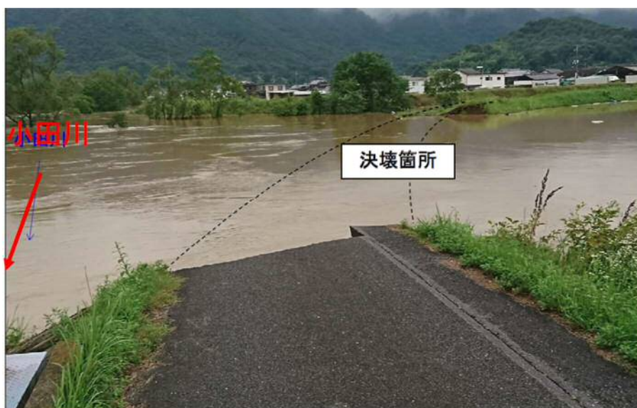
写真 4.2.2 小田川 6.4k 破堤状況(7/7 被災時、中国地整記者発表資料より)
