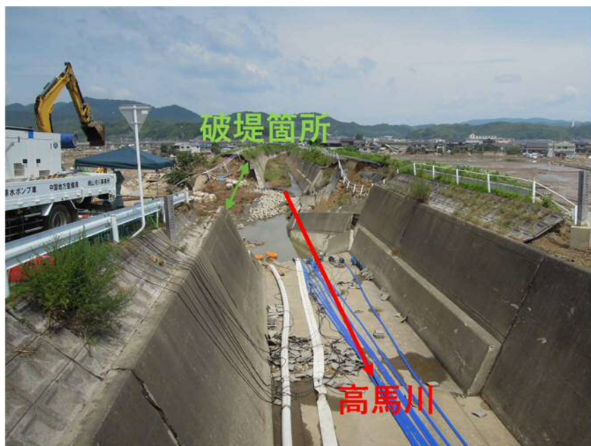
写真 4.1.2(1) 支川高馬川の破堤状況（7/13 調査時）
