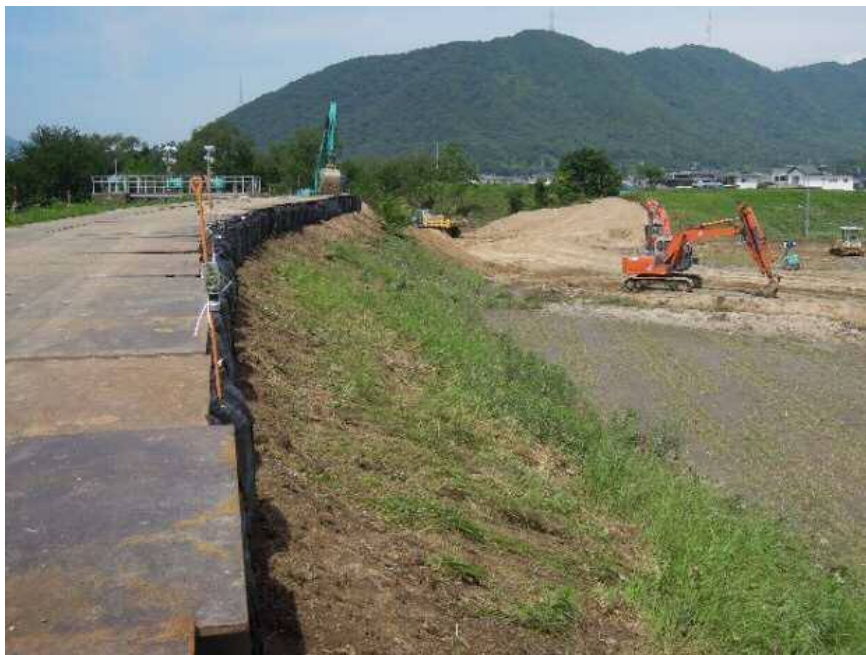
写真 4.2.1 小田川 6.4k 破堤状況 (7/13 調査時)
