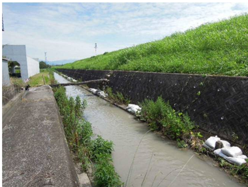
写真 4.6.1 被災箇所の状況
