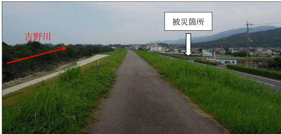
写真 4.5.1 被災箇所堤防の全景
