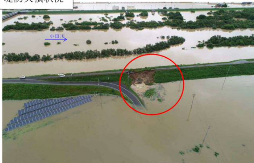
写真 4.3.2 小田川右岸 0.6k 被災状況(7/7 被災時、中国地整記者発表資料より)
