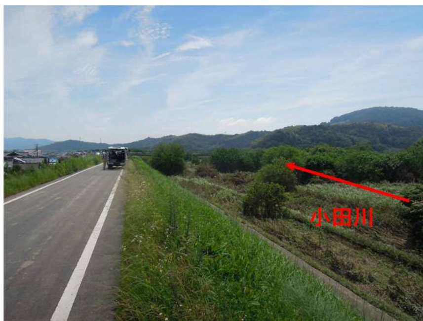
写真 4.1.3 破堤箇所付近の植生繁茂状況（車両の奥側が破堤箇所）
