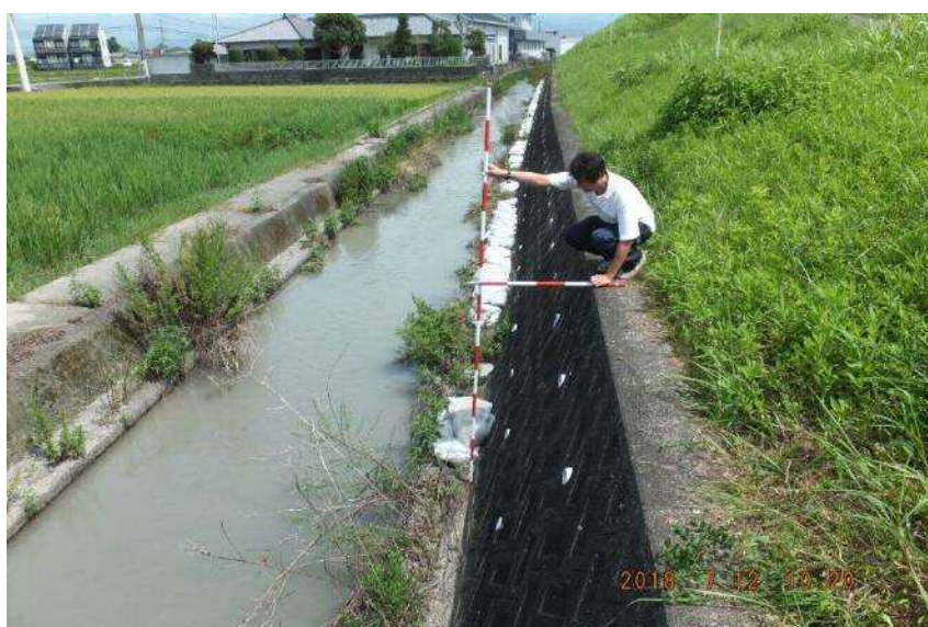
写真 4.6.2 被災箇所堤防の裏のり尻の状況
