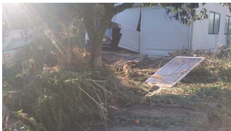
写真 5-26 倉庫の入口が損傷している。ソーラーパネルが流出している。
