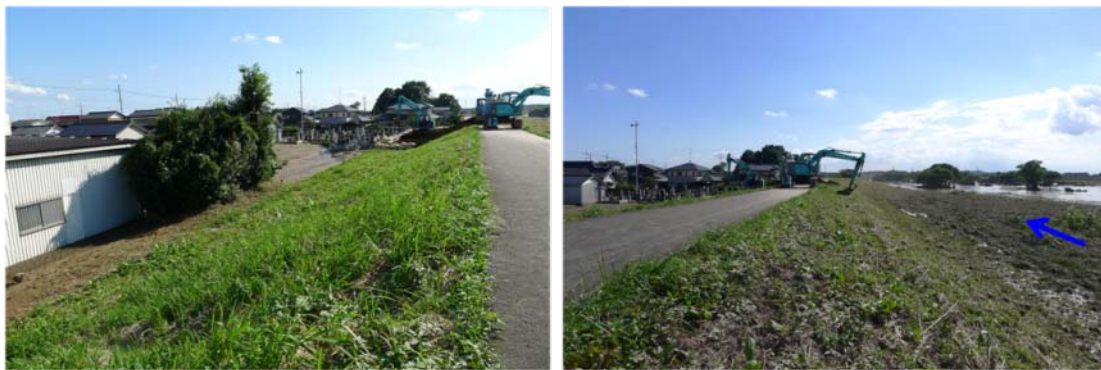
(a) 決壊地点下流側の堤防裏法の状況
