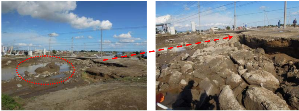
写真 2-6 落堀下流端の固結粘土の塊
