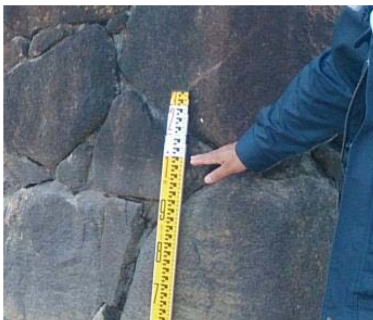
写真 5-28.29 塀の浸水痕跡は1 m程度
