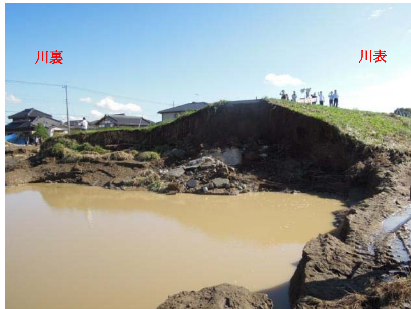
写真 2-1 決壊断面（下流側）
