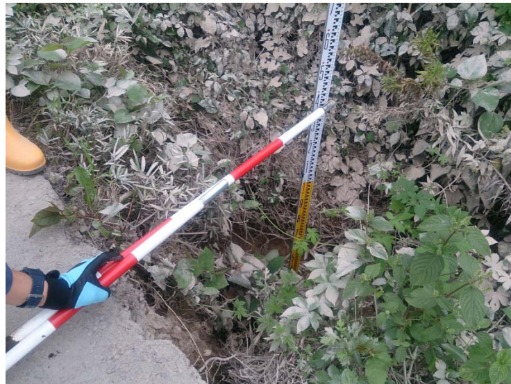
写真 4-12 八間堀川から越水による堤内地側の侵食跡
