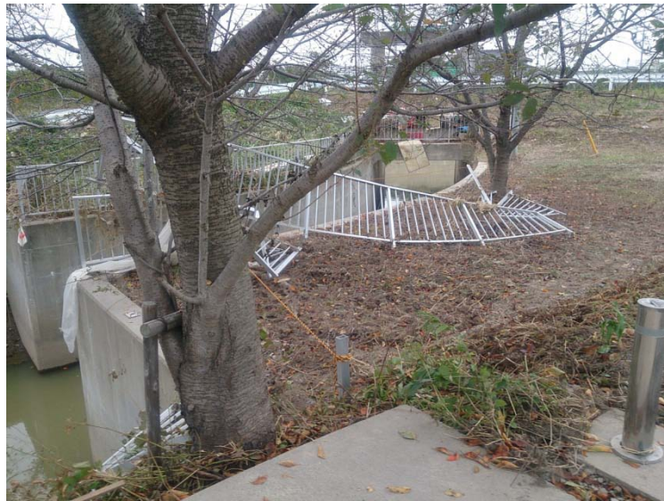
写真 4-11 氾濫水によるフェンス破壊跡
