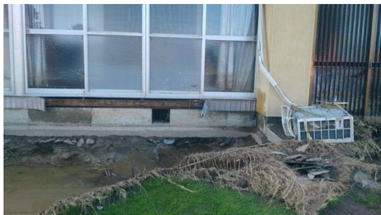
写真 5-24 家屋の下部が洗堀している
