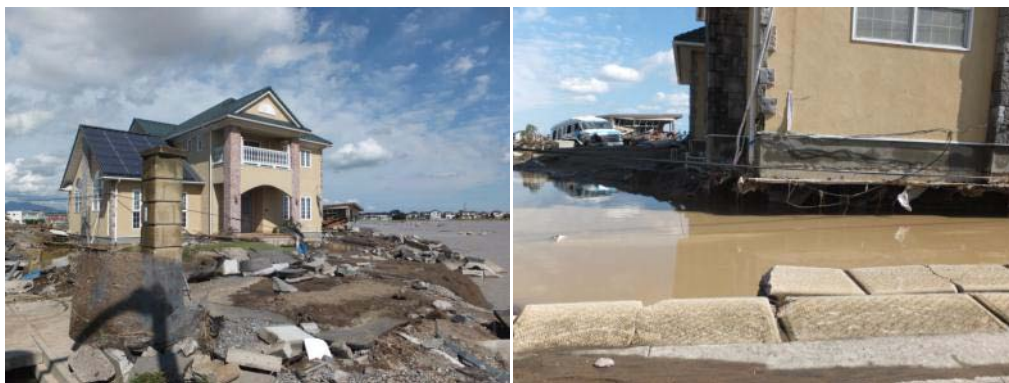
写真 5-8.9 外見の損傷はあまりないが、建物の下部が洗堀された家屋
