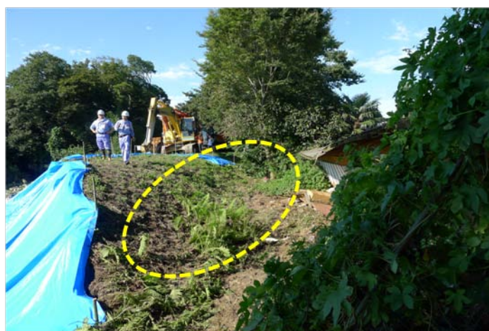
写真 2-8 決壊地点の上流側堤防裏法面を望む
