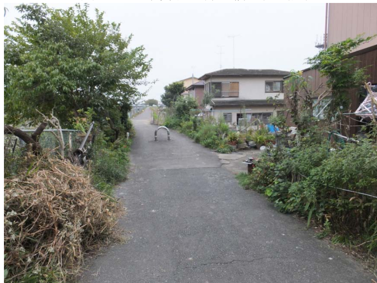
写真 4-9 八間掘川左岸側の堤内地には越水の痕跡はない
