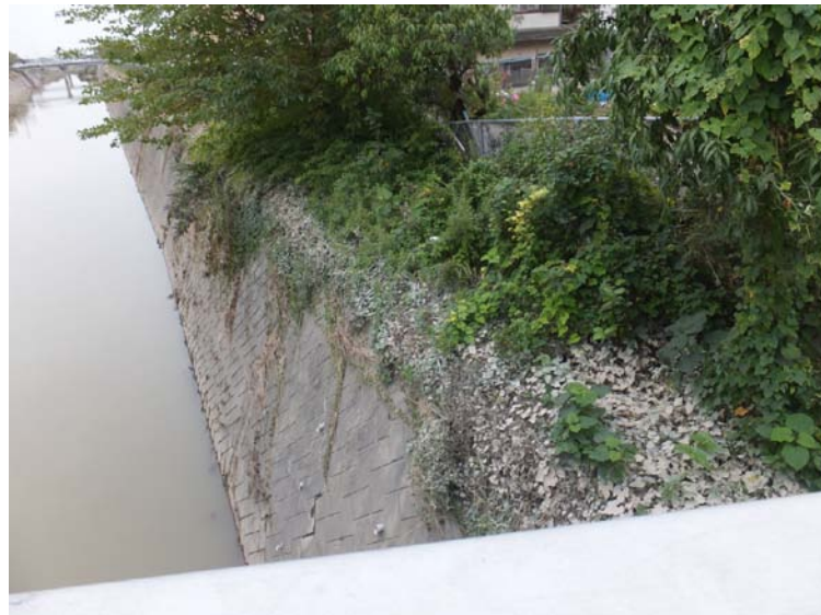
写真 4-8 八間掘川左岸の橋の洪水痕跡
