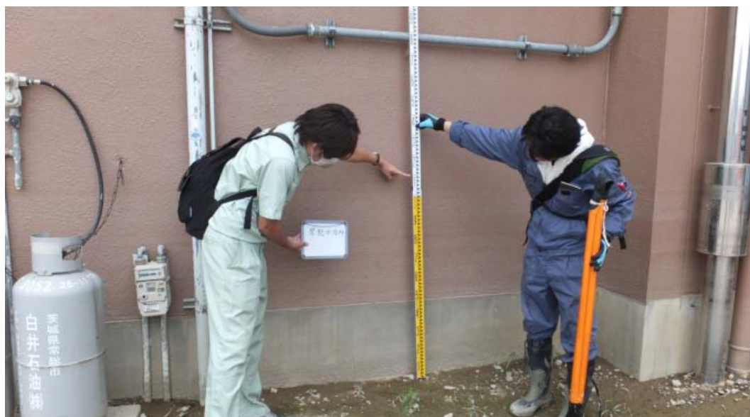
写真 6-1 常総市役所の浸水深痕跡
