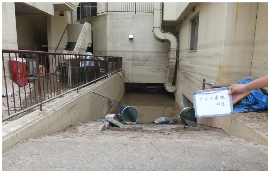
写真 6-17 さくら病院地下階の水没状況
