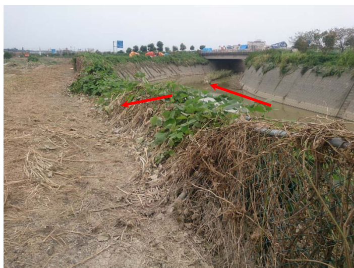
写真 4-15 八間堀川左岸からの越水の痕跡
