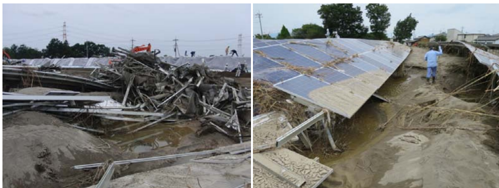
写真 3-17 復旧箇所堤内、太陽光発電サイトの被災状況
