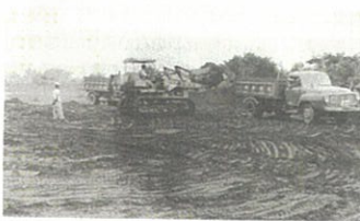
『ダンプトラックによる運搬』 エキスカベーターと機関車による組み合わせ施工が少なくなってからダンプトラックによる運搬が主役になった
