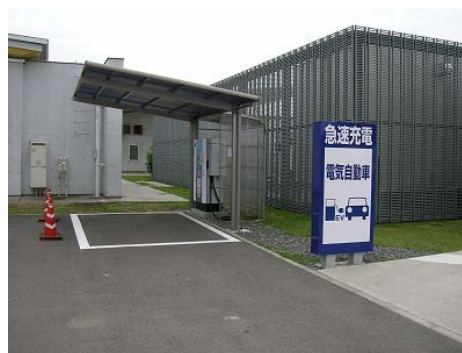
写真-3 EV用急速充電施設を備えた道の駅 (道の駅思川)
