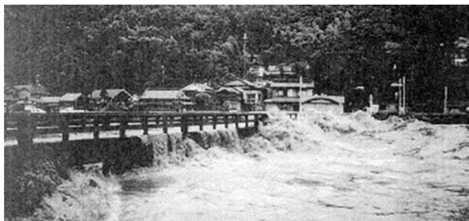
桁下高不足による支障事例
