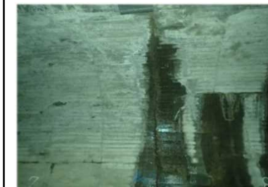
損傷状況（うき・漏水）
