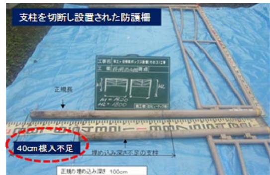
写 - 1 粗雑工事の事例
